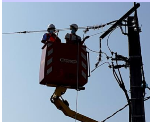
Le « coupé du dernier câble aérien »
